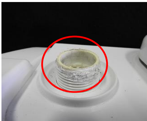
①洗濯機の給水口のねじ山の劣化
